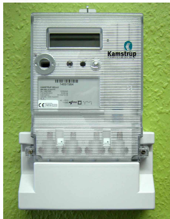
Die neuen, intelligenten Zähler in Großkrotzenburg
